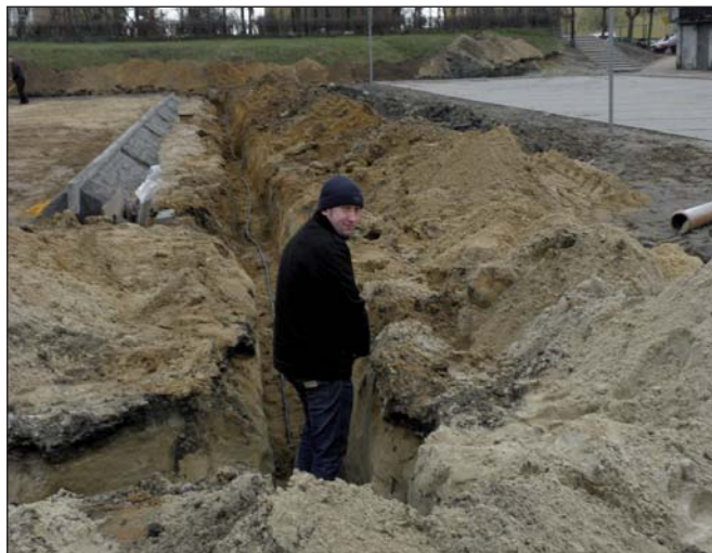
Na zdjęciu: mgr inż. Paweł Szulc – specjalista ds. budowlanych Urzędu Gminy sprawdza prawidłowość umiejscowienia kabla energetycznego i bednarki w wykopie – inwestycja: ORLIK przy GOK w Woli Krzysztoporskiej.
